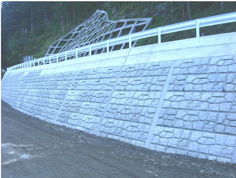
丸亀産業株式会社「村道島谷線道路災害復旧工事」(宮川村役場建設課) 使用ブロック : 100 型、125 型 (擬石)
