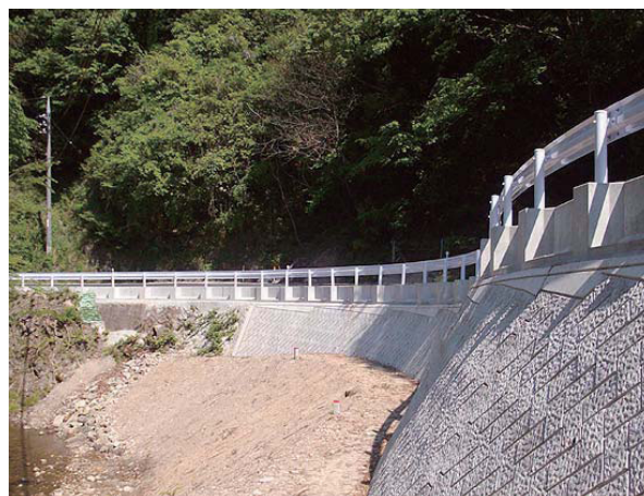
積ブロック直上設置の事例
